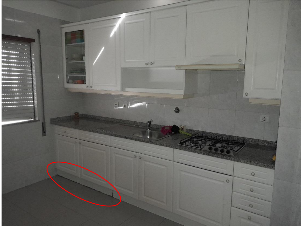
Cozinha – Móveis de cozinha em estado razoável, com sinais evidentes do uso e com o rodapé deteriorado
