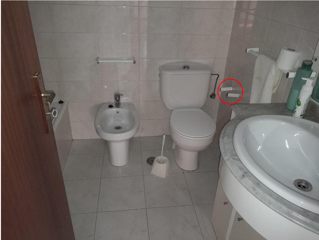
W.C. – Loijas sanitárias em estado razoável, tendo o sido substituído o mecanismo de autoclismo
