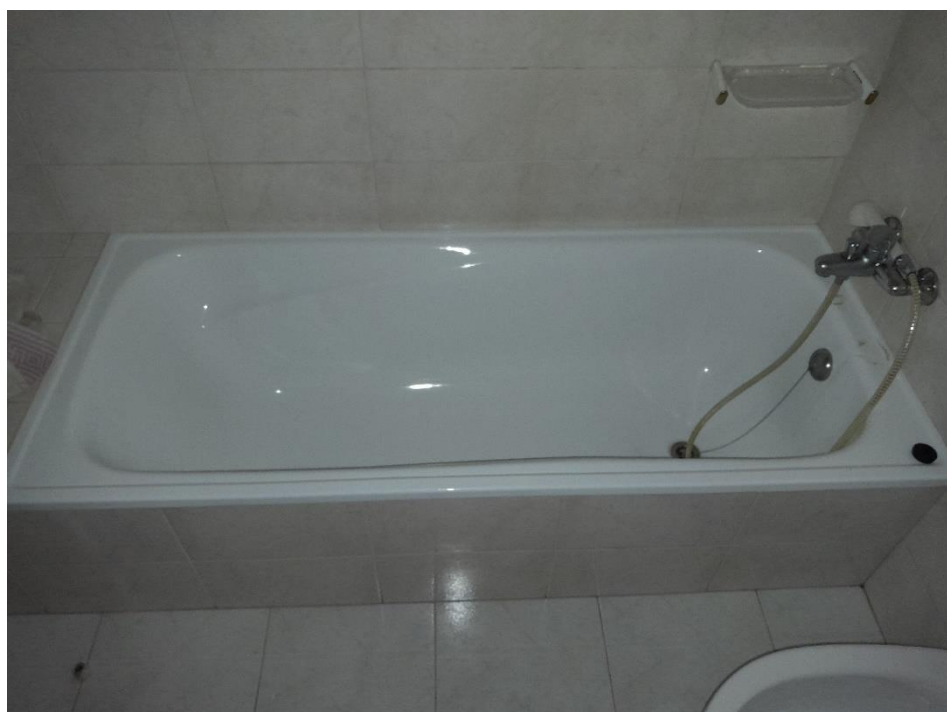
W.C. – Banheira em estado razoável, com danificada em dois pontos
