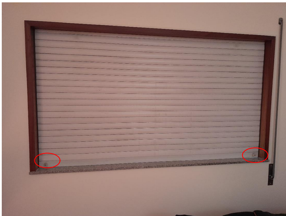
Sala – Caixilharia de janela em bom funcionamento, com roldanas novas; - Estore em bom funcionamento com batentes deteriorados
