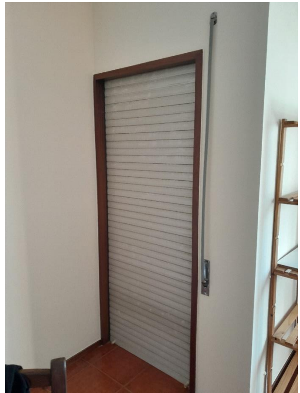
Sala – Porta de abrir reparada, segundo a proprietária a porta arrastava no pavimento; - Estore em bom funcionamento, com fita nova
