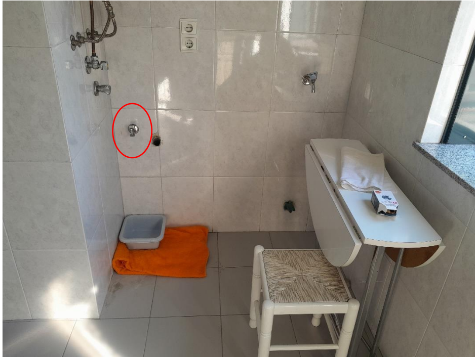
Cozinha – torneira de corte da MLR com deficiente vedação
