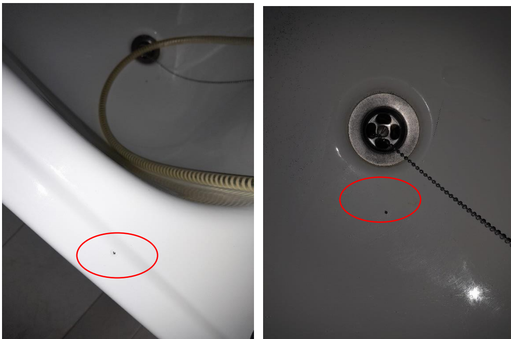
W.C. – Banheira em estado razoável, com danificada em dois pontos
