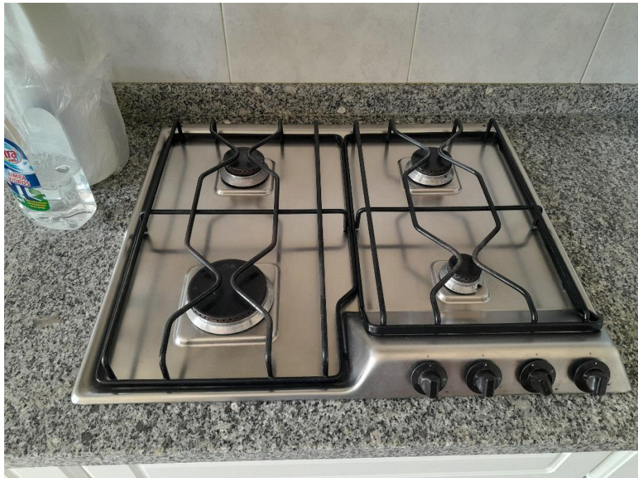
Cozinha – placa de fogão a gás em estado razoável
